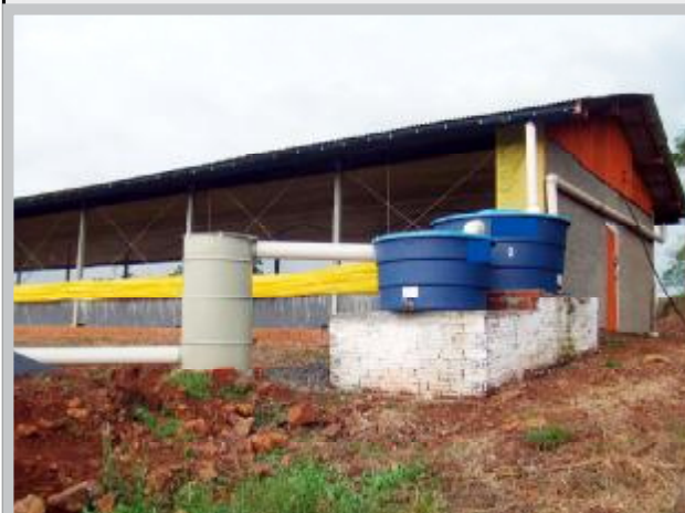
VISTA panorâmica de um sistema de captação e filtragem da água da chuva em uma instalação rural
